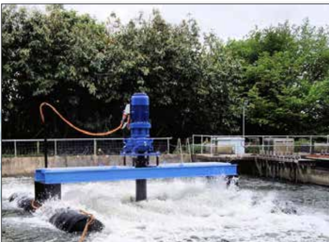
huurbeluchter met drijfconstructie
