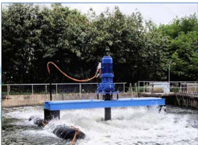
huurbeluchter met drijfconstructie
