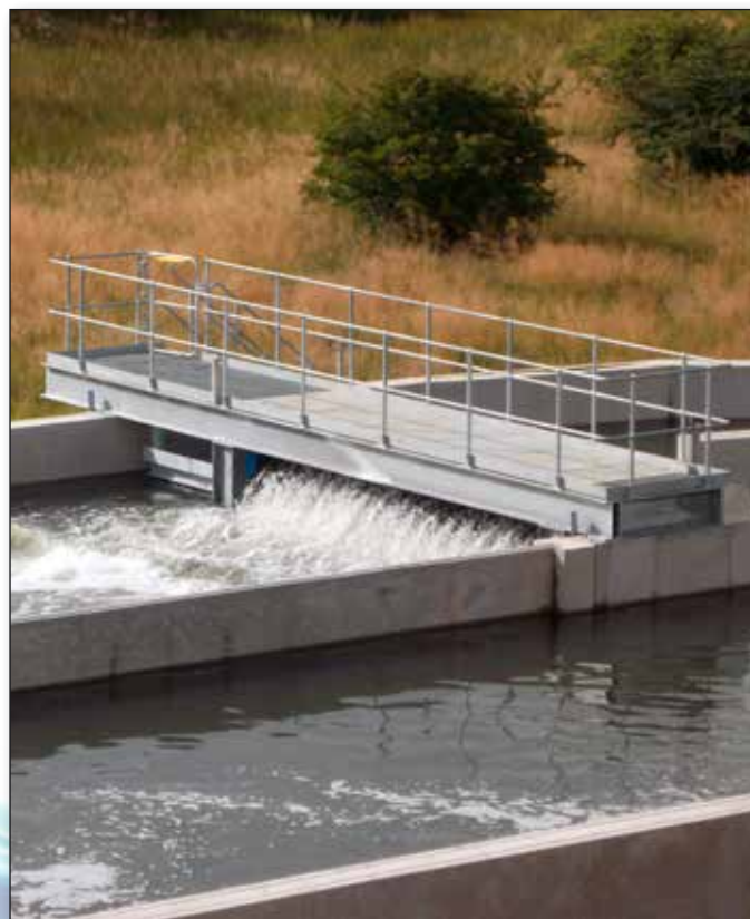
Aérateur à brosse Landy monté sous pont en acier
