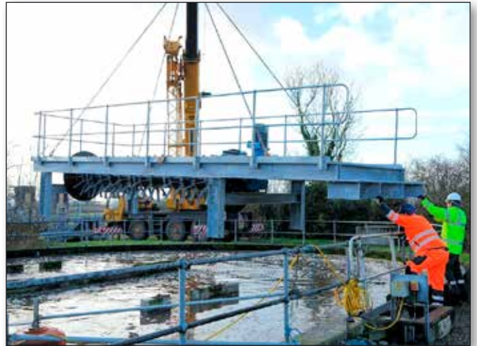
Mise en service sur site
